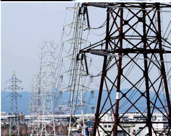
関西と関東の電力系統は送電線で行なっている(大阪府大東市)
